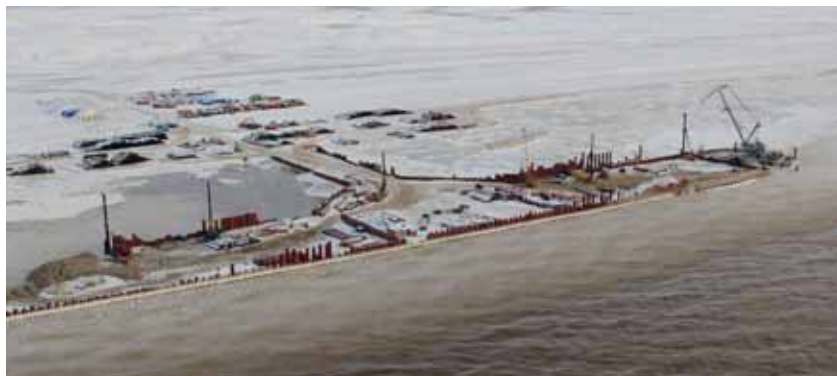
Строительство комплекса причальных сооружений с использованием технологий трубошпунта возможно даже в Заполярье
